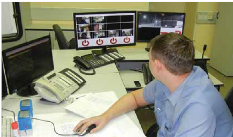
Рабочее место дежурного по станции, оснащенное цифровыми мультисервисными пультами с функциями видеоконференцсвязи и видеонаблюдения
