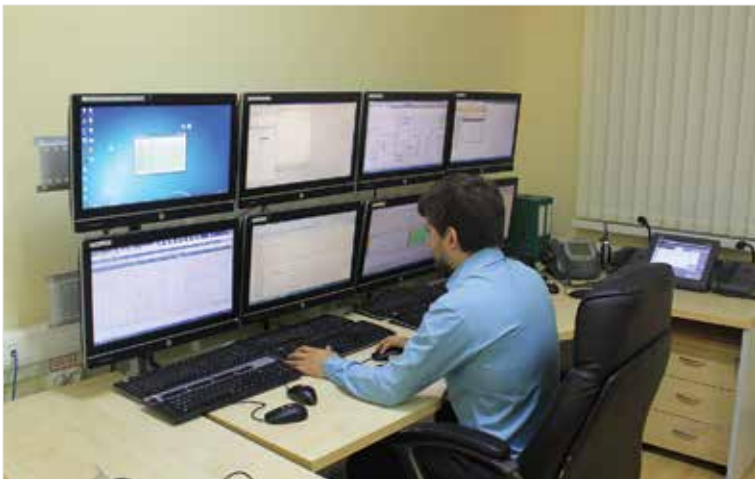
Рабочее место сменного инженера резервного Центра коммутации GSM-R (станция Адлер Северо-Кавказской дороги)
