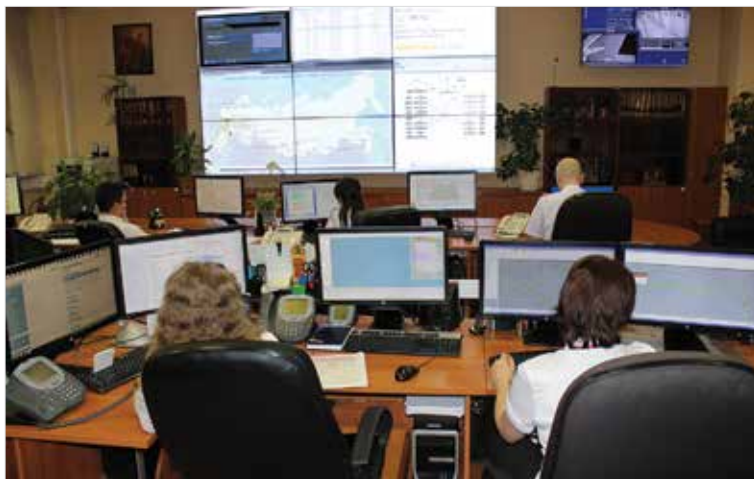
Центр управления технологической сетью связи (ЦУТСС)
